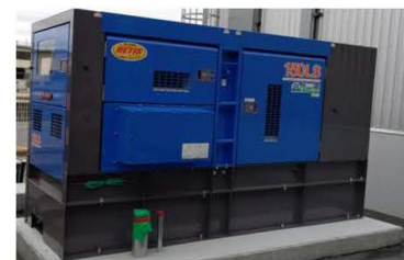
<非常用電源設備>
